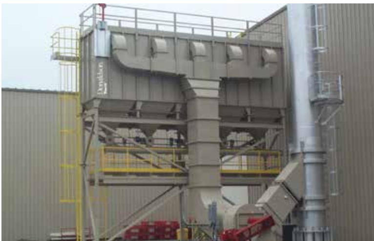
405MBT8 en una Instalación de Manufactura de Ladrillos
